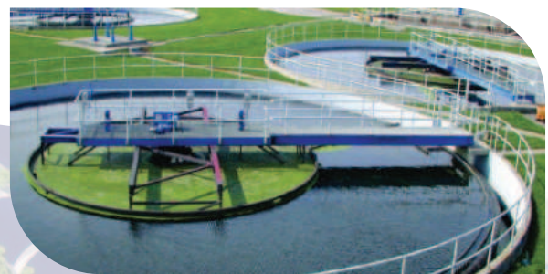
Nhà máy xử lý nước thải / 1200 m 3 / ngày đêm
