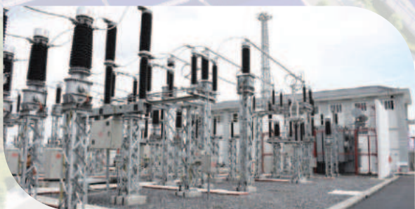
Trạm biến áp 110/22KV
